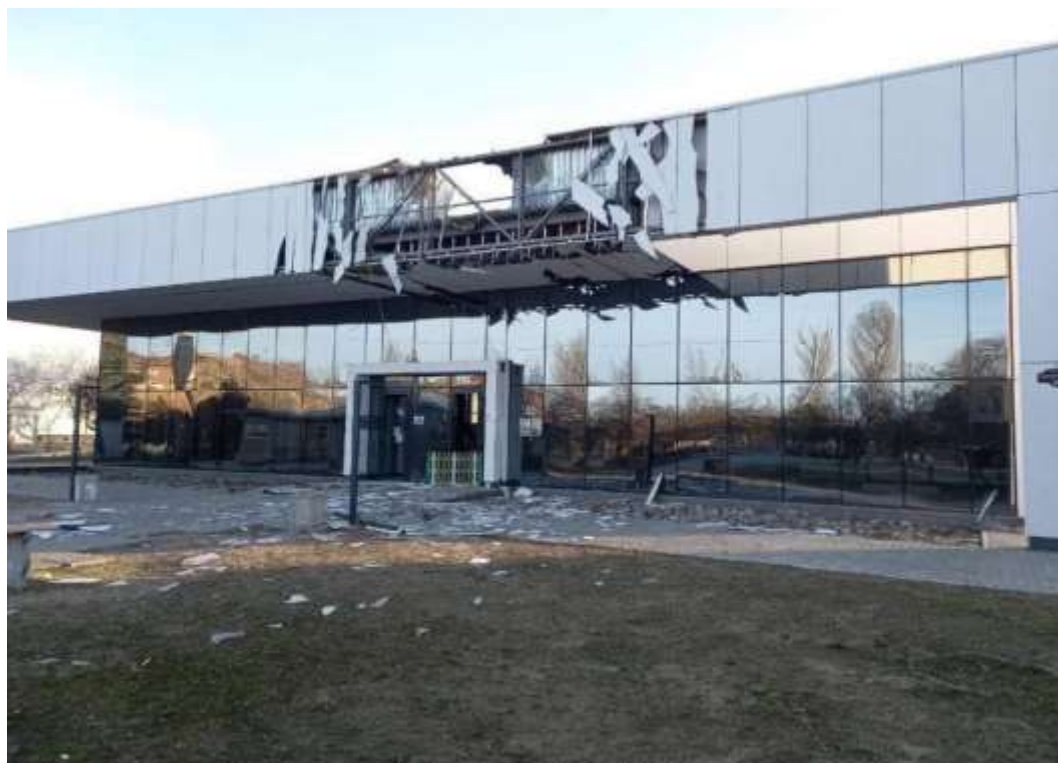
Рис. 2.1.4. Фотофіксація будівлі після руйнування. Екстер'єр.
