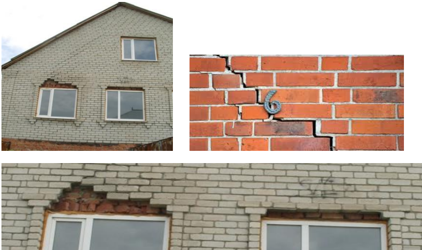
Рис. 33. Вигляд зруйнованої стіни, над вікном у якій немає перемички
