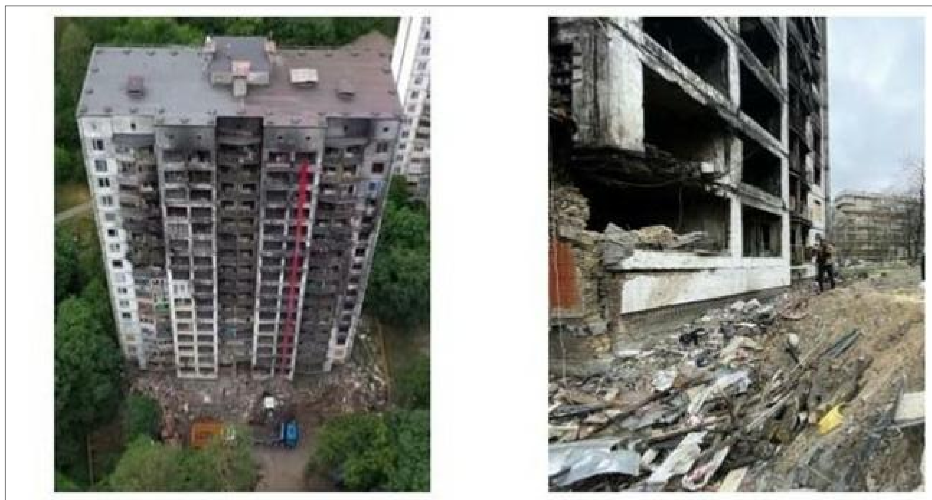
Рис.2. Пошкодження багатоквартирного великопанельного будинку серії БПС по вулиці Чорнобильській, м. Київ
