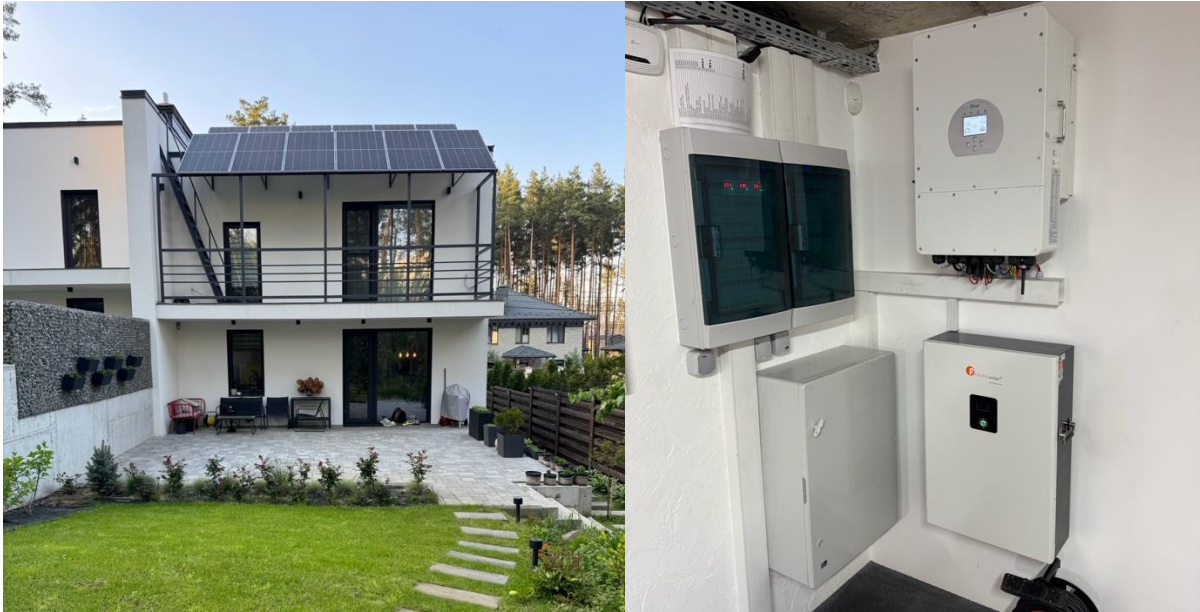
Рисунок 4. Зліва-направо: загальний вигляд будинку, на плоскій покрівлі якого встановлено побутову сонячну електростанцію; система інвертора, акумулятора і обв'язки ФЕМ.
