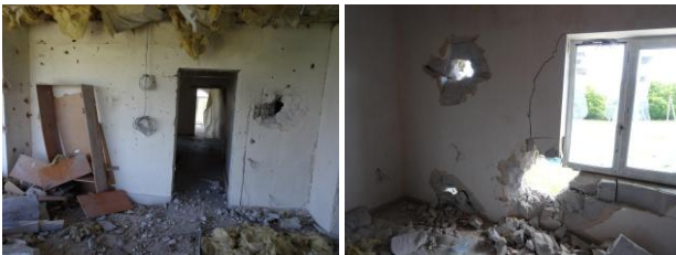
Рисунок 1. Пошкодження стін із ніздрюватого бетону – наскрізні отвори різних діаметрів
